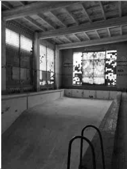
Фото №43: Вид бассейна
