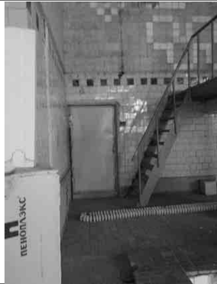
Фото №44: Вид бассейна
