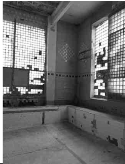
Фото №40: Вид бассейна
