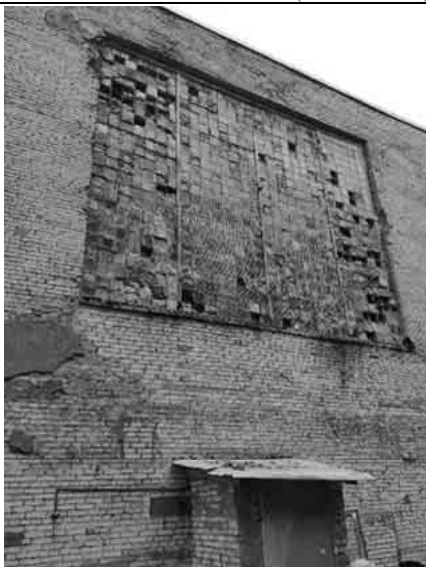
Фото №3: Внешний вид здания (окно в помещении с бассейном)
